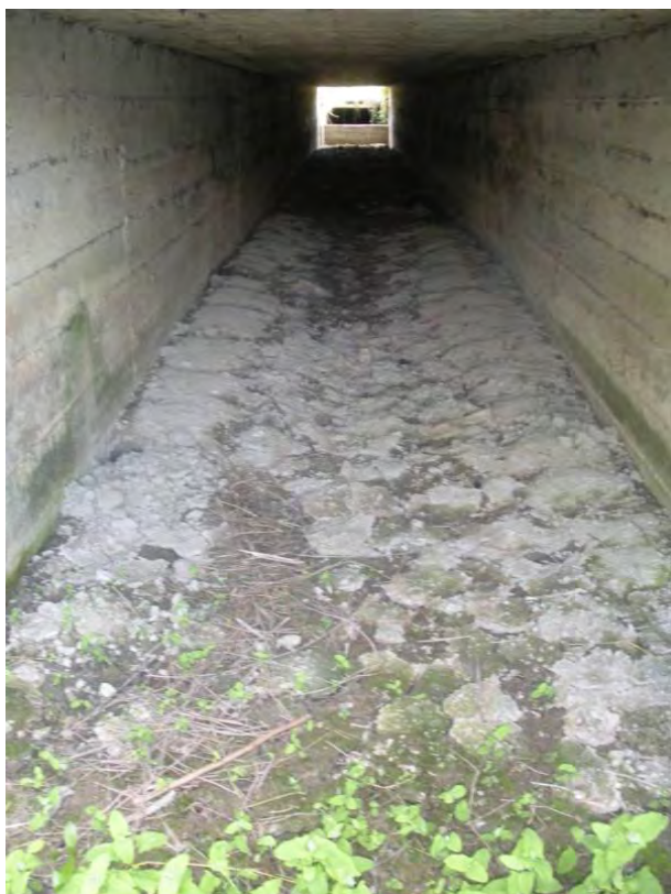
Tracciato della gora ricoperto da fango e terra. Particolare sottostante allo svincolo della superstrada in direzione Cireglio.
