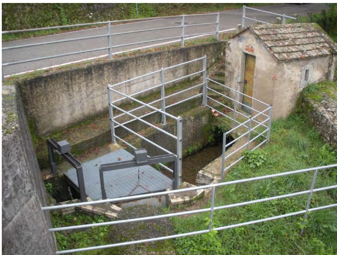
Via Crespole e Fabbriche, presso il ponte sulla Bure di Baggio. Dettaglio della presa della goricina di Candeglia. Casottino e serrande: di regolazione per il deflusso e di troppo pieno.
