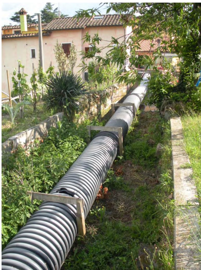
Via Carota e Molina. Tratto in cui la goricina di Candeglia è convogliata in un tubo in plastica a causa di infiltrazioni nelle proprietà sottostanti.
